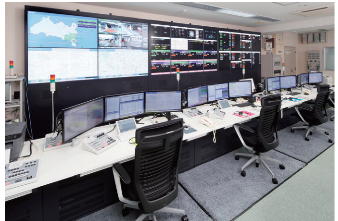
高機能消防指令センター
